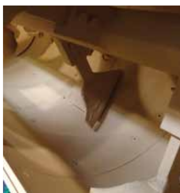
Футеровка камеры плитам из специального износостойкого материала
